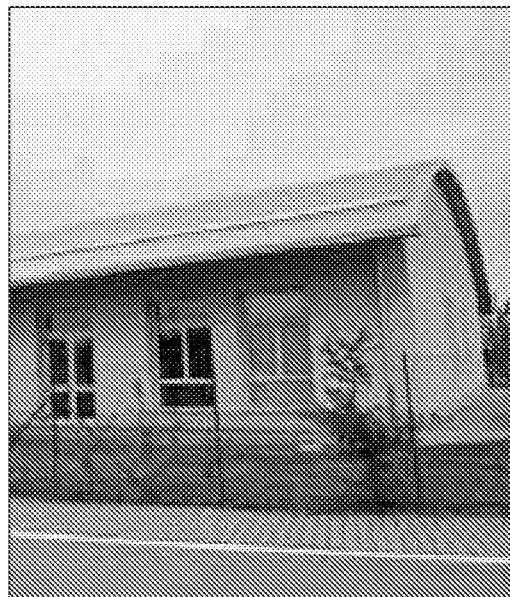
Asilo di Bagnolo contaminato da amianto
